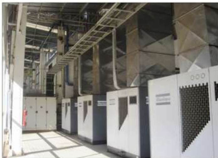
Barracão de gás e compressores (vista interna)
