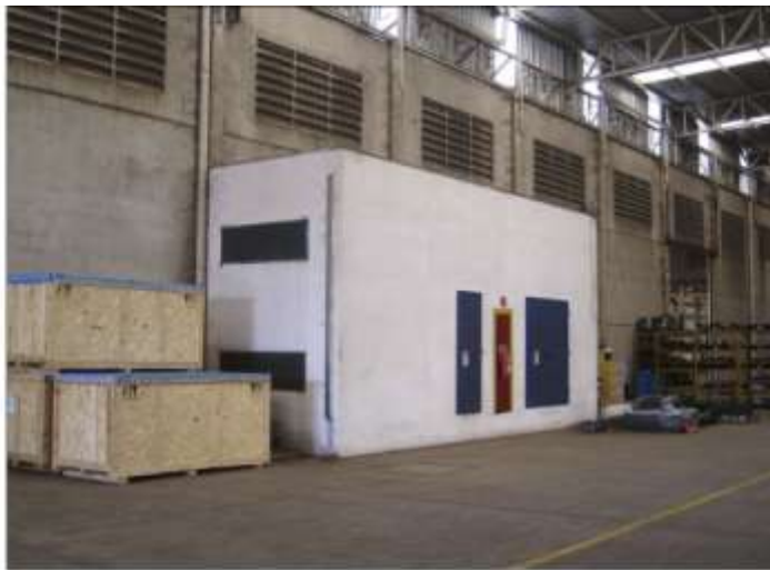
Galpão - Cabine de força (vista interna)
